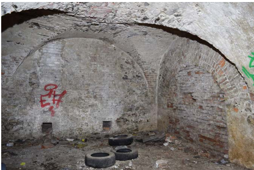
Klenutý sklep pod sýpkou s dodatečně proraženým otvorem větráku ve vrcholu klenby (otvor byl znovu zazděný), 2022. (foto: P. Borský)
